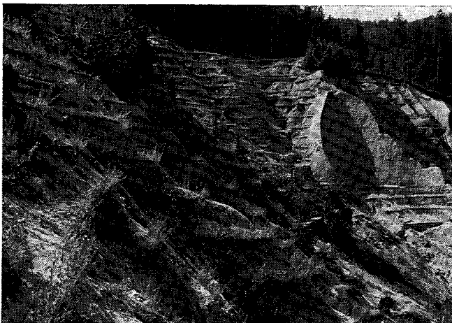
Abb. 1: Alte Rutschhangverbauung ohne Rasensaat, nur mit Hilfe von Krainerwänden und Buschlagen.
